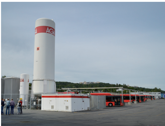
Gasinfrastruktur im Busdepot Oslo Vest (Quelle: 3N)
